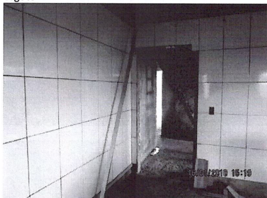
Figura 9 - 16/01/2019 - Detalhe revestimento cerâmico
